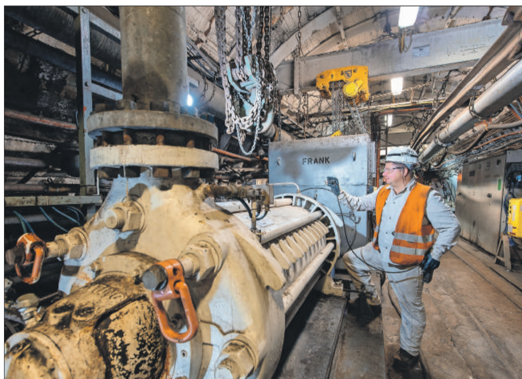
Ein Kumpel kontrolliert die Pumpe „Frank“ in etwa 1000 Metern Tiefe in der seit Ende 2018 geschlossenen Zeche Prosper-Haniel. Foto: Klingenburg/Ruhrkohle AG/dpa
